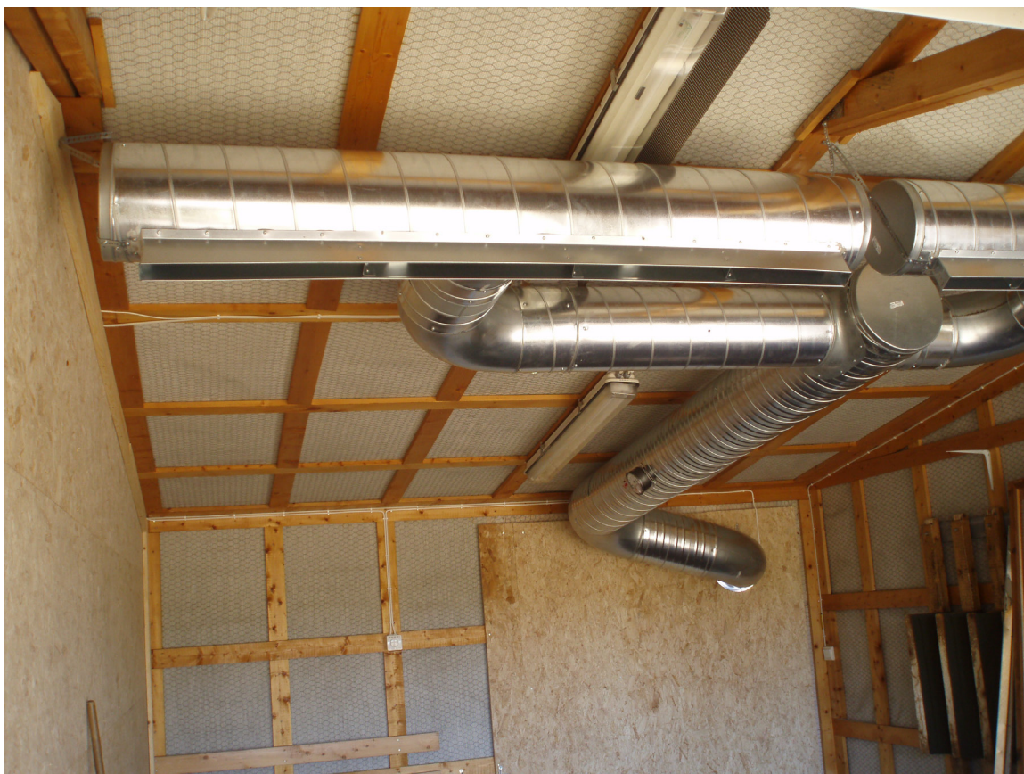
Figur 1.1 Ventilasjonssystem montert på overbygd standplass
