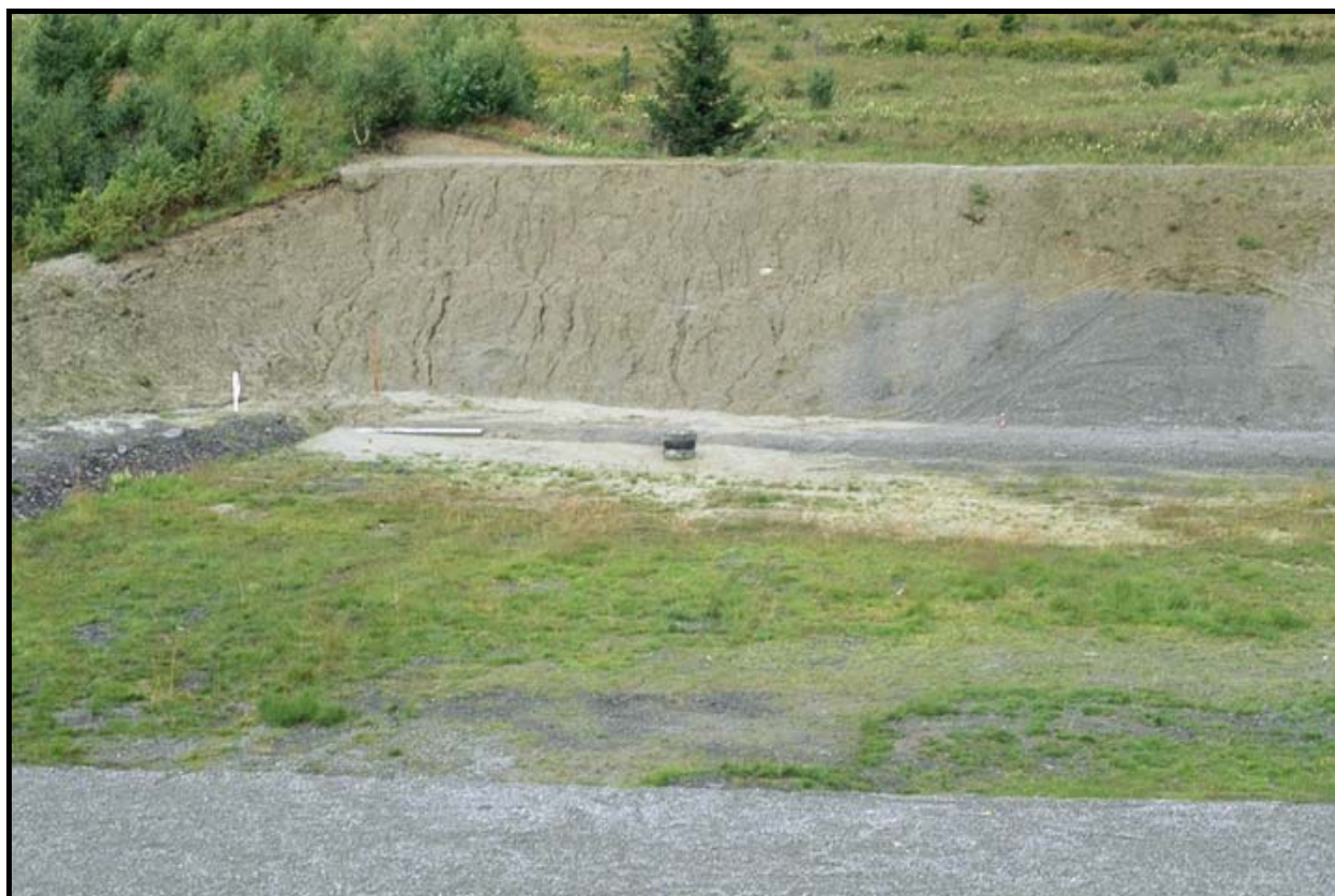
Figur 5.13 Bildet viser bane M hvor massene i fangvollen viser tydelige erosjonsfurer. På lokaliteten var det fylt på grovere jordmasser over den naturlige jordarten som i dette tilfellet er hav og fjordavsetninger. I etterkant er det skjedd en utglidning av jordmassene
