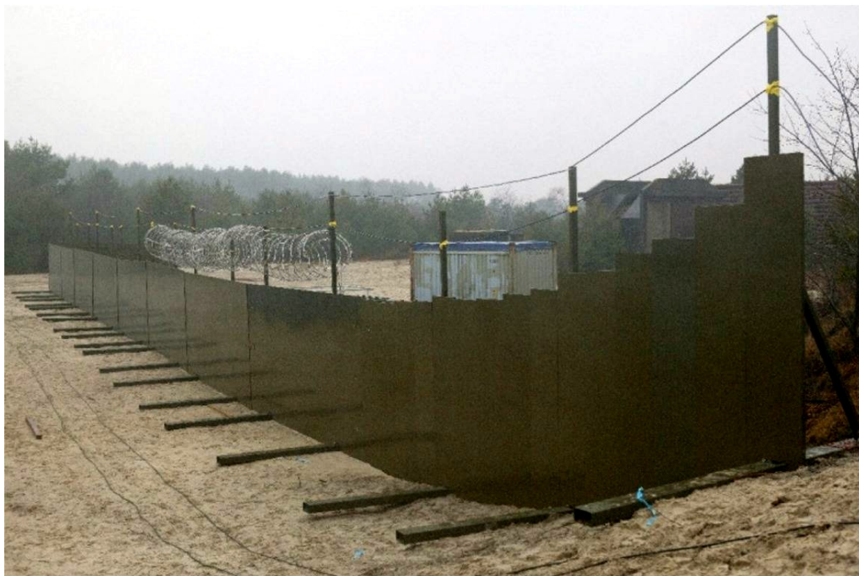
Figur 2.1 Pansret gjerde med sensorkabler på bakken foran gjerdet og på toppen av gjerdet (foto: WTD 91, Meppen, Tyskland).
