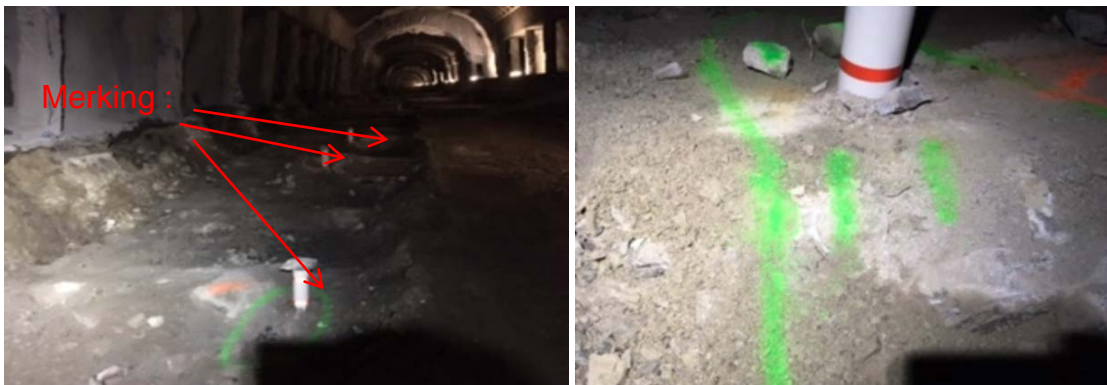
Figur 4.13 Funn av eksplosiver i Høyenheitunnelen.
