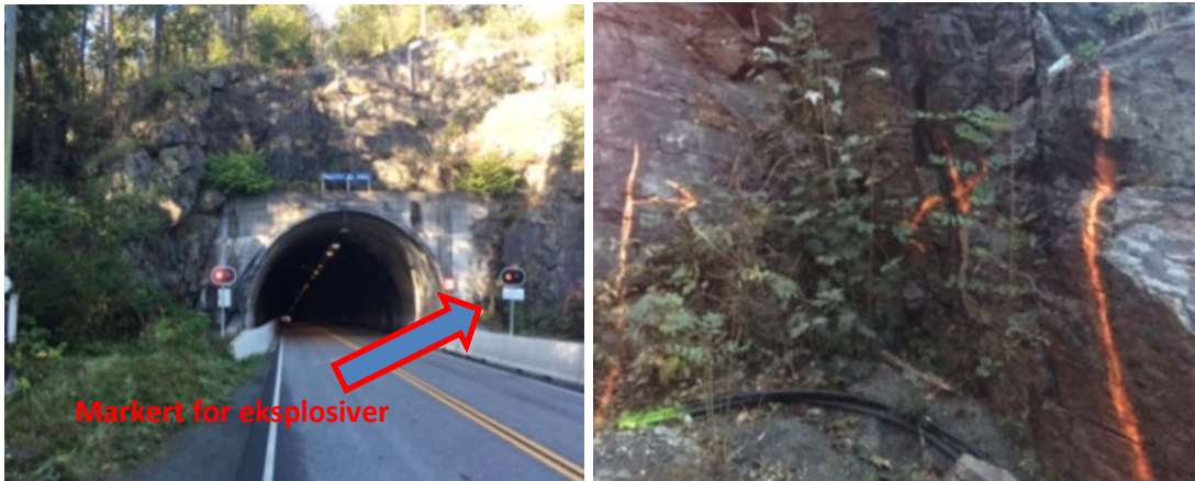
Figur 4.10 Funn i skjæring utenfor tunnelen.
