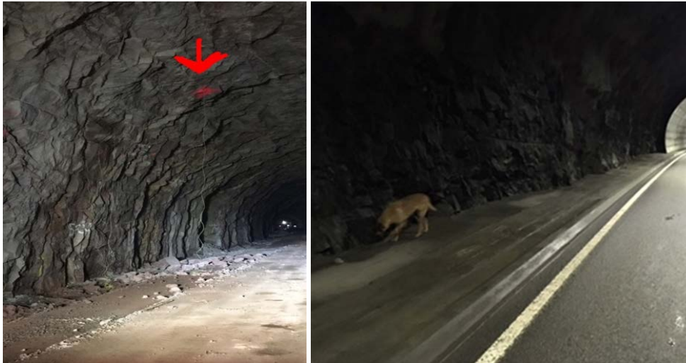
Figur 5.1 Deteksjon på bakken fra stoffer som er transportert via kondensvann fra taket.
