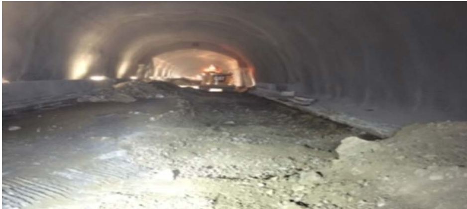
Figur 4.12 Ved dybder ca. 40 cm over fjell i Høyenheitunnelen.
