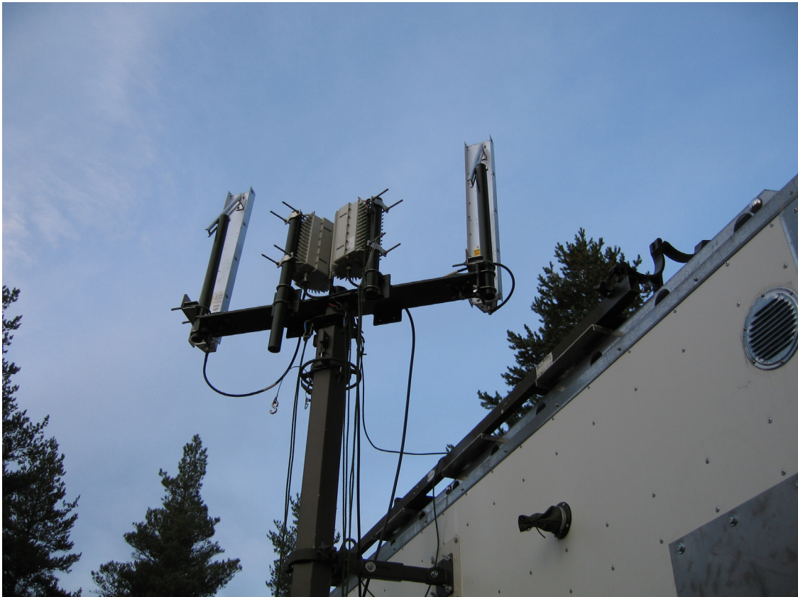
Figur 2.9 Antenner plassert på mast.
