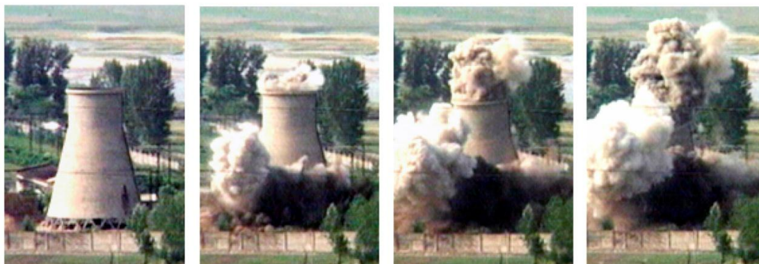
Figur 4.13 Sprengning av kjøletårnet til Reaktor to i Yongbyon, 26. juni 2008. (Scanpix - AP Photo)
