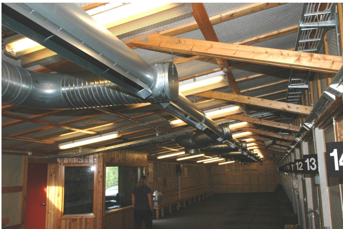
Figur 1.1 Ventilasjonssystem montert på overbyggd standplass (skyttebane 4).
